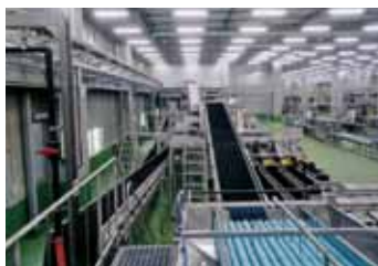
凍結準備室 [原料選別ライン] 魚体形状・重量の違いによってサイズ選別を行い、D/B入、シール、ラベル貼り、バンド掛、梱づけまで連続的に進めます。
