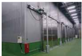
凍結室前 16.8t/DAYが4室、33.6t/DAYが1室。計5室の日産凍結能力は、100t/DAYとなります。
